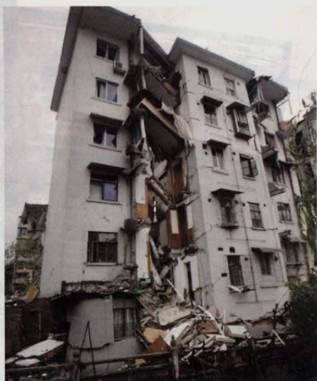
2008年5月14日，四川绵竹市汉旺镇东汽公司家属区内被震裂的居民楼
