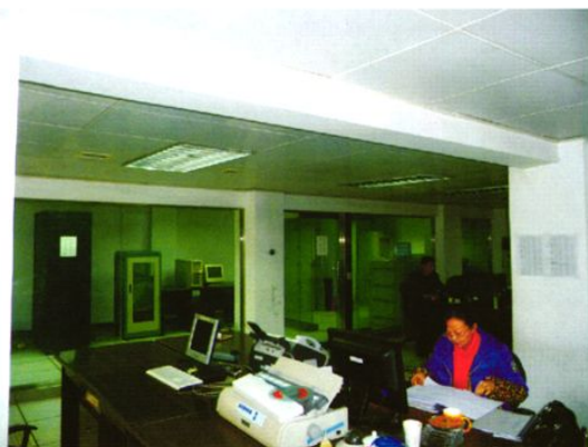
县联社中心机房
