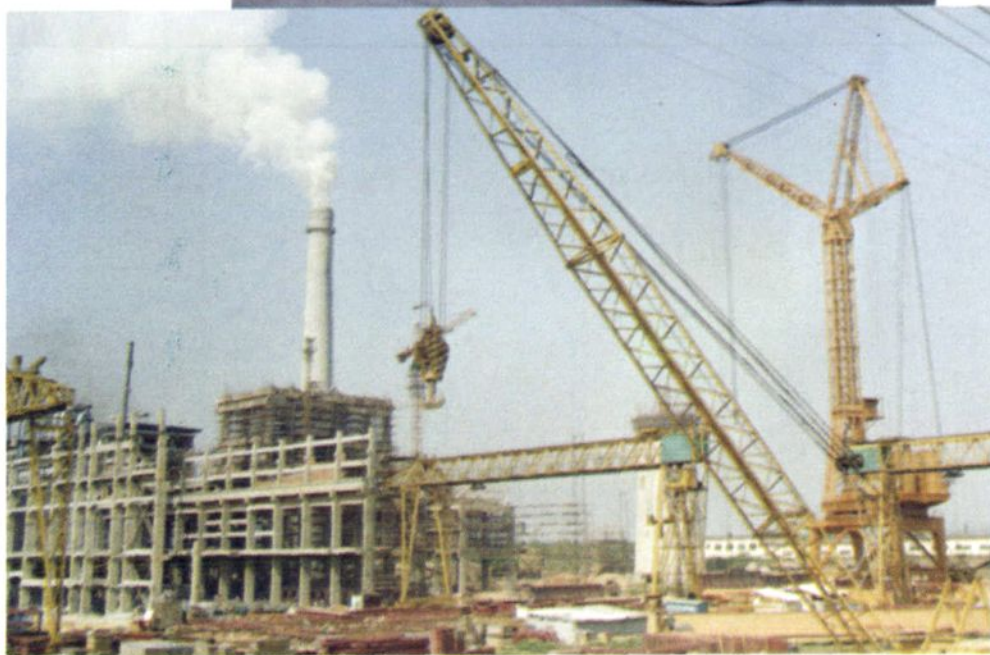
景德镇发电厂技改工程雄姿
