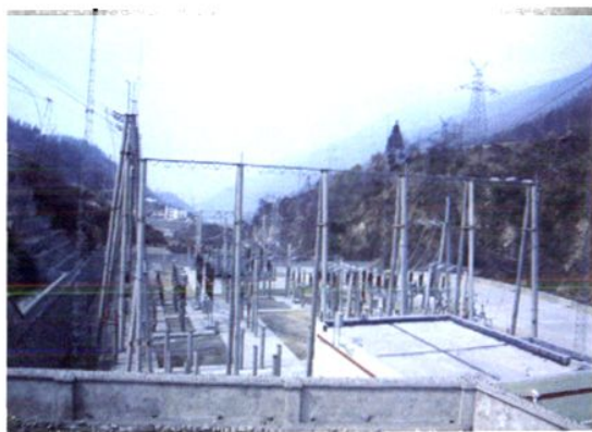
11万千伏变电站
