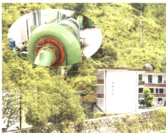
铁索桥电站（股份）装机3200KW
