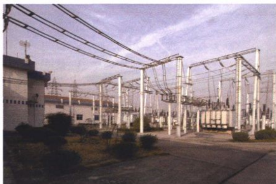
2000年9月，如东县建成第一座110千伏综合自动化变电所——江海桥变电所
