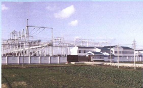
2002年6月，220千伏洋口变电所外景
