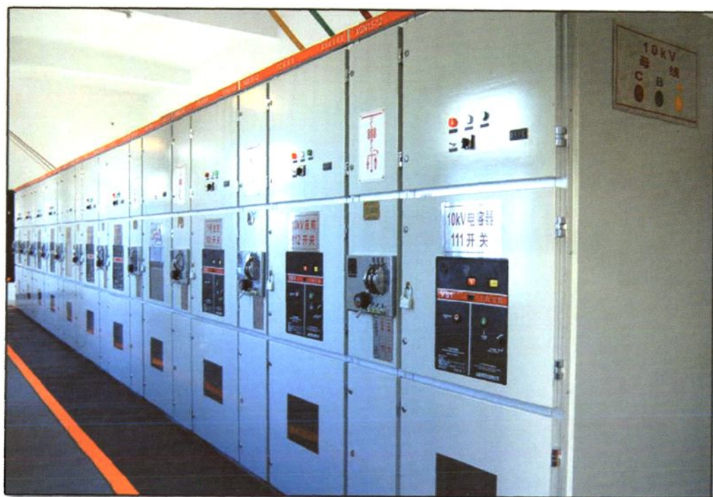
35千伏无人值守运行庙前变电所10千伏开关柜
