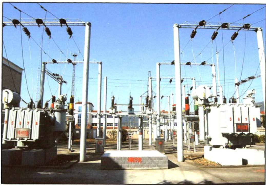
35千伏无人值守运行庙前变电所室外装置
