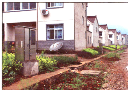
2007年4月，新的配电设施装点了新农村
