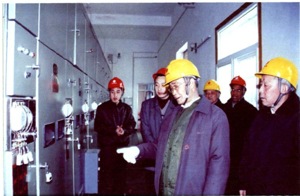
青阳供电局老领导非常关心电力事业建设，图为李应庭局长等 老领导参观视察城西35千伏变电所
