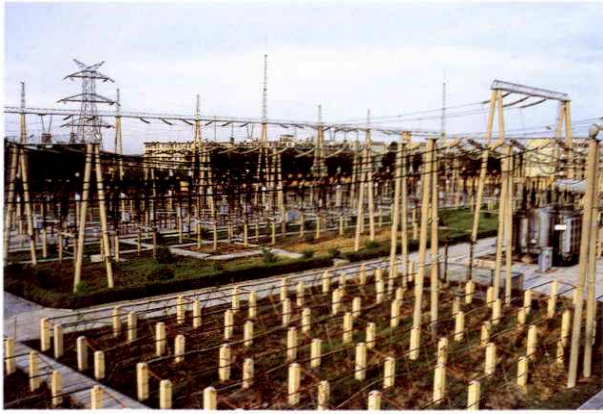
昌吉变电所出线塔
