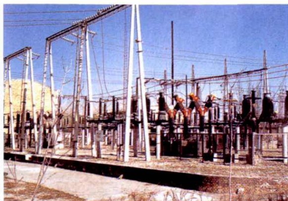
110千伏伊犁中心变电所
