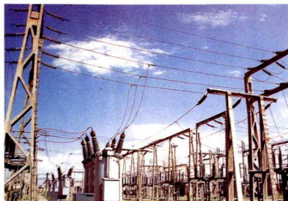
1964年建成的新疆第一座110千伏变电 所-三宫变电所
