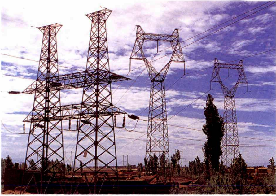
玛-昌双回220千伏送电线路铁塔
