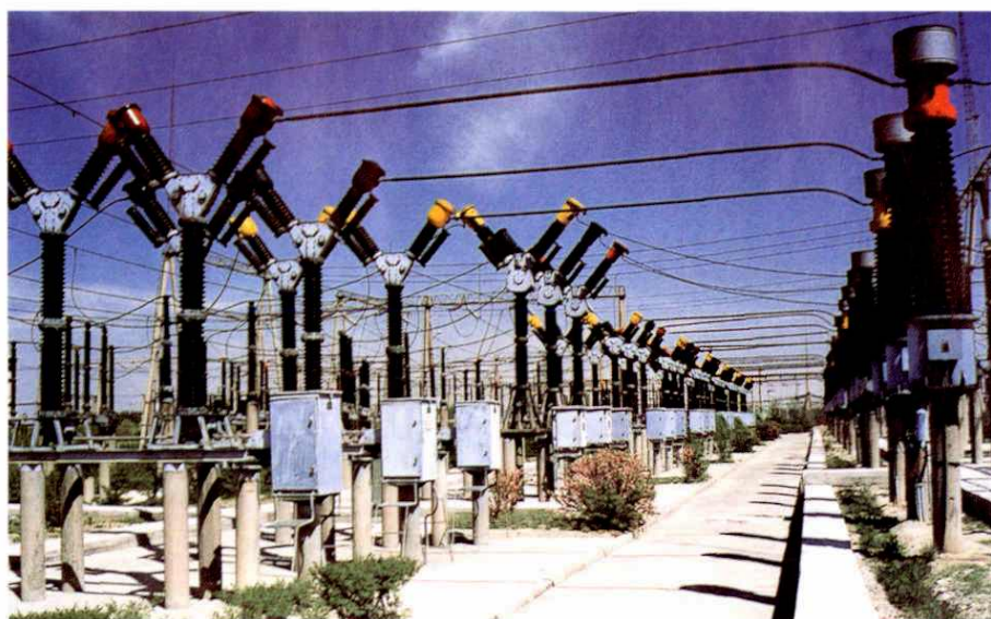
220千伏米 泉变电所
