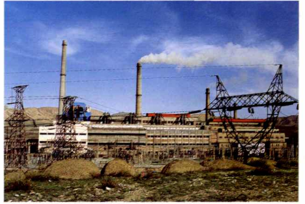
红雁池电厂出线铁塔群
