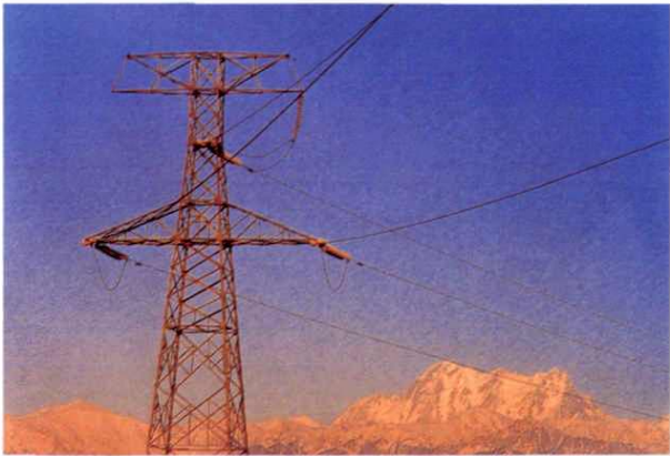
米泉-甘河子110千伏线路转角塔
