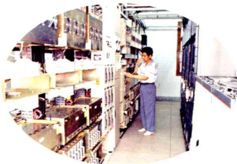
移动通信机房
