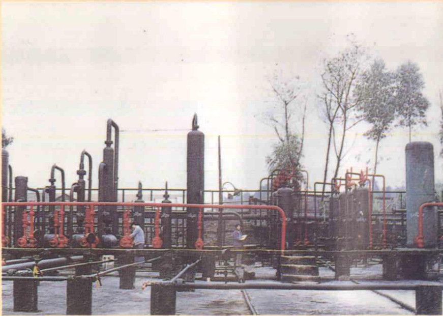
◀ 傅家庙气田 多井集气站
