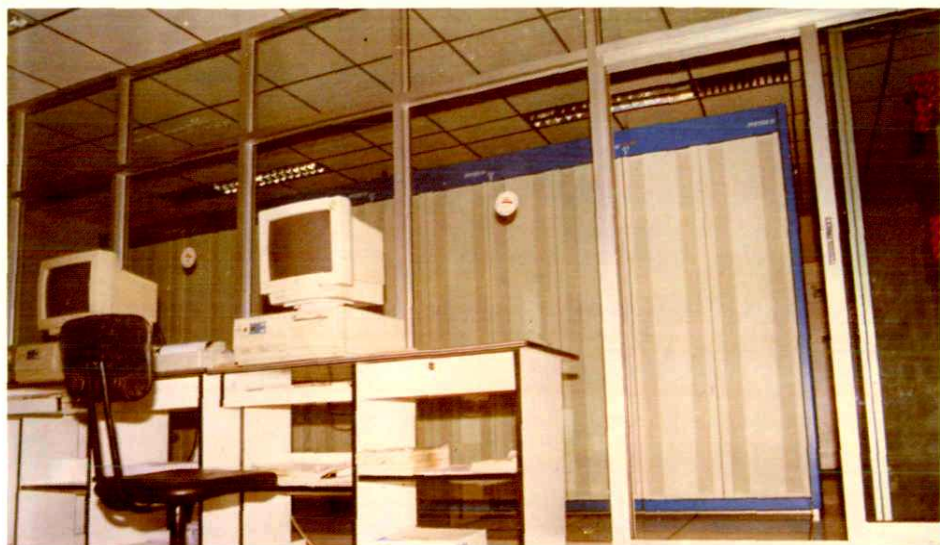
隆德县邮电局 4000 门程控电话 交换机房
