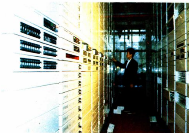
毕节地区邮电局市内自动电话交换机房。
