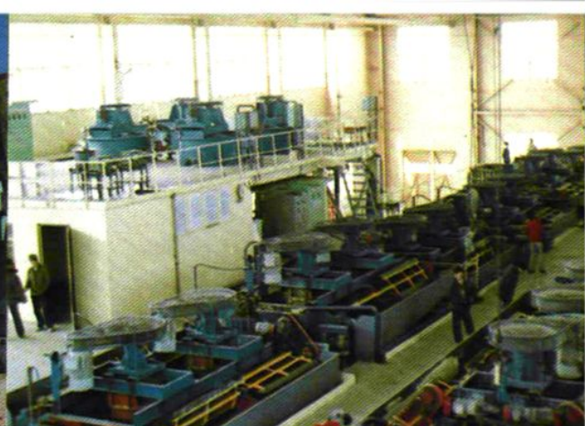
年产钾肥 20 万吨的青海钾肥厂浮选车间投入生产
