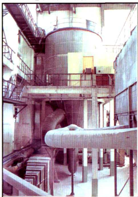
南昌化工原料厂引进美国制造的直径为7100毫米超低碳喷雾干燥塔
