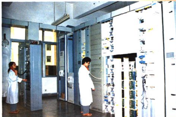
光纤传输机房（1995年）
