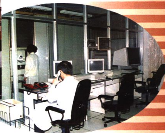
程控电话机房（1994年）
