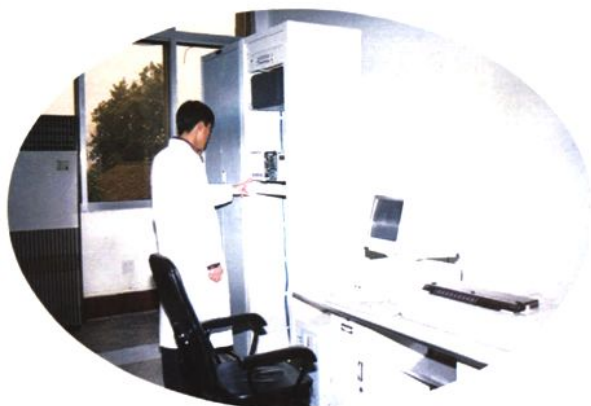
分组交换机房（1996年）
