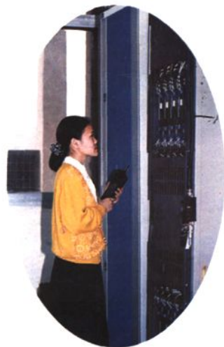
移动电话机房（1994年）
