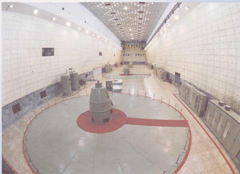
► 大化水电厂发电机层全景
