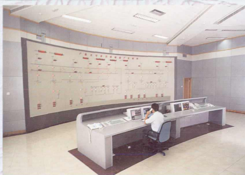
◀ 大化水电厂中控室
