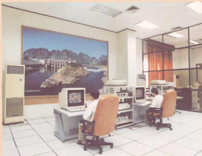
▲ 百龙滩水电厂中控室
