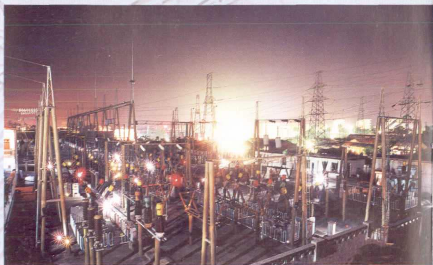
大化水电厂开关站 ▶
