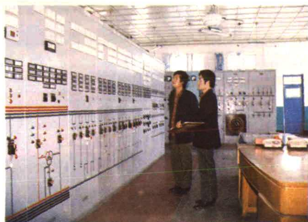
大板一次变电所主控室
