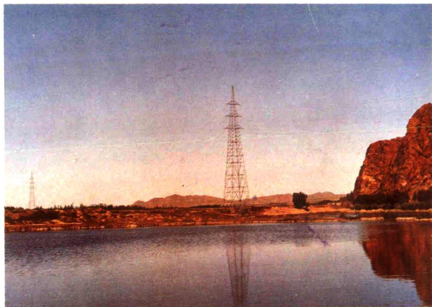
赤乌 110 千伏线路红山铁塔
