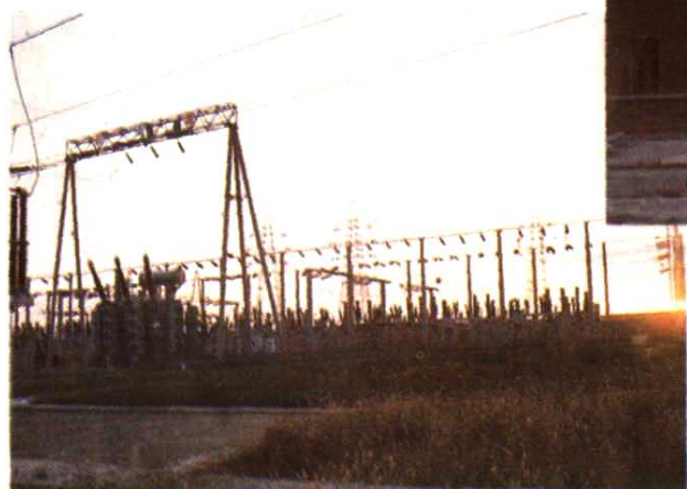
元宝山一次变电所开关场地
