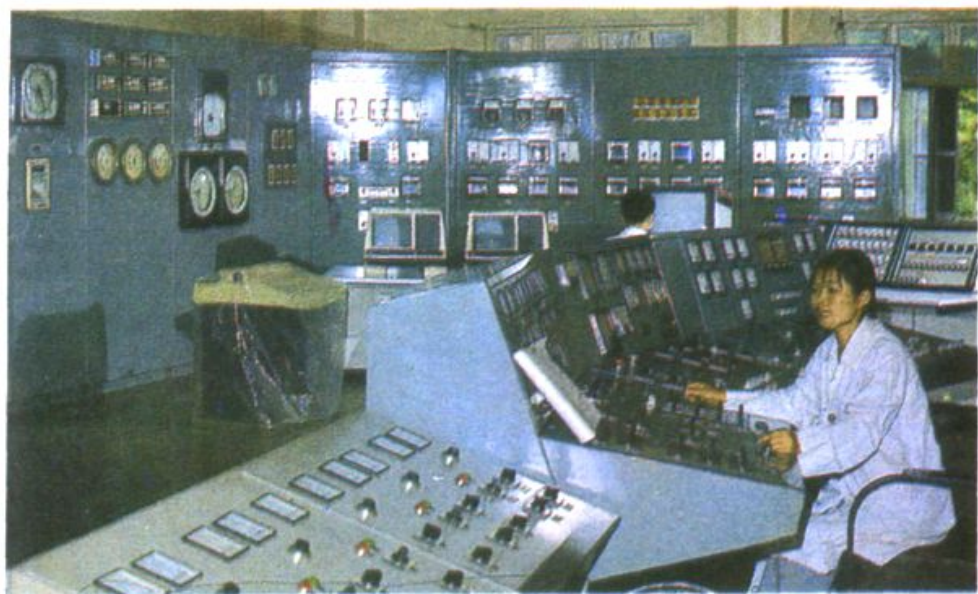
凤凰山 铜矿自 动控制 室
