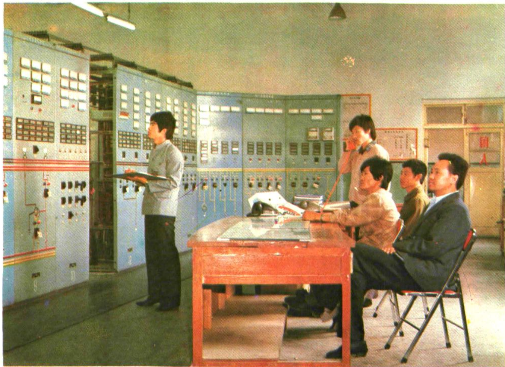
王段变电站主控室
