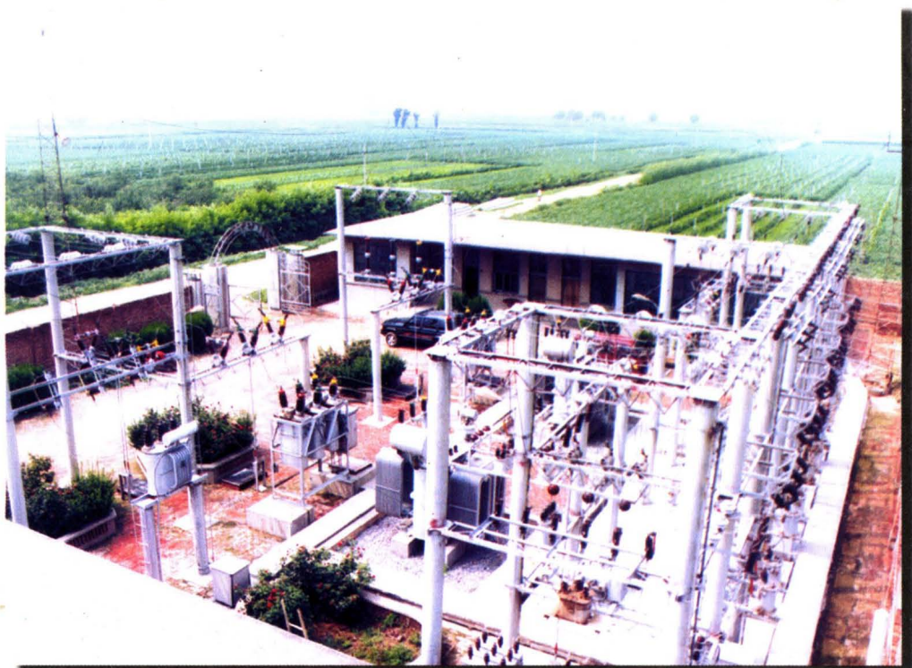
王国针 35KV 变电站
