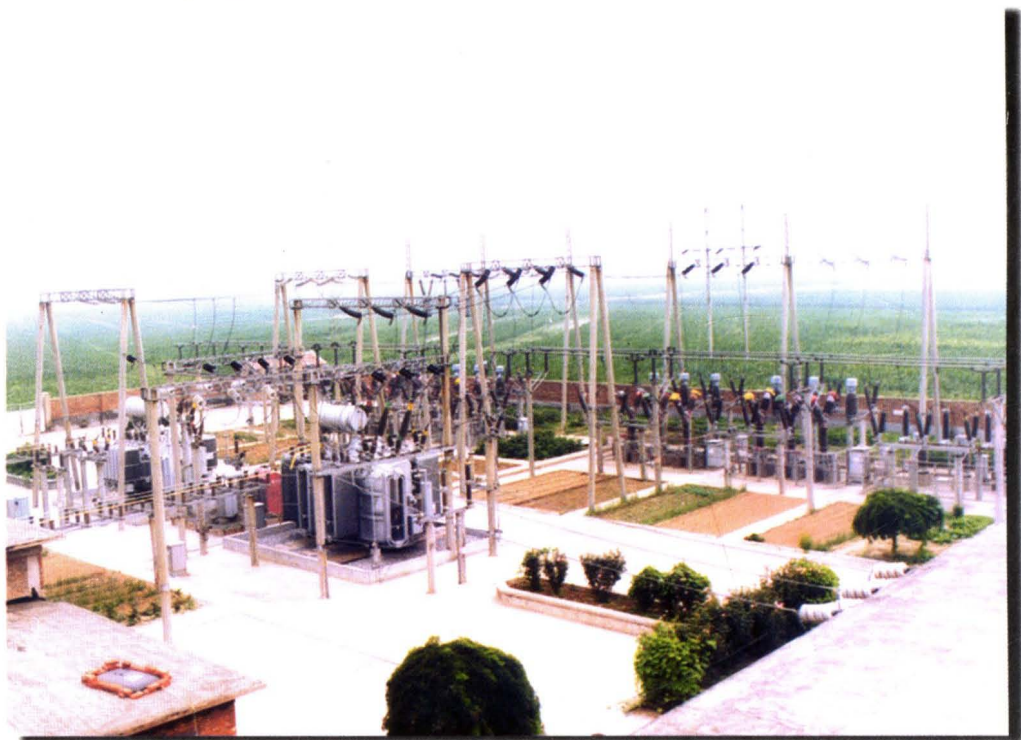
乌马营 110KV 变电站
