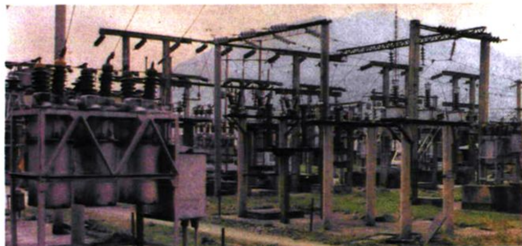
↓ 老七五35千伏变电站。
