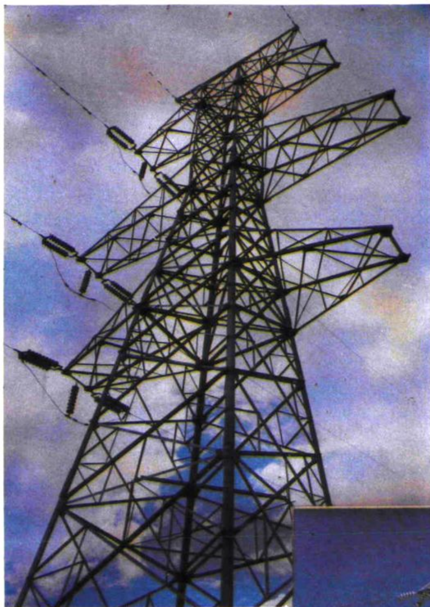
←拔地而起的 110千伏高压 输电线路。
