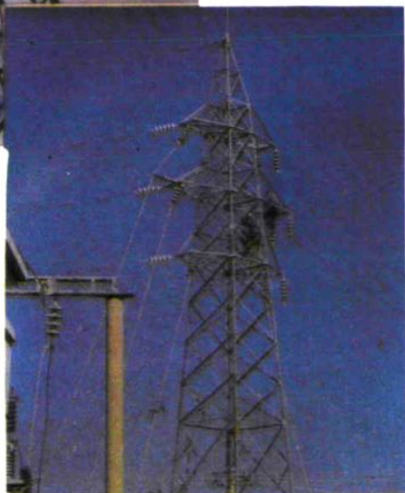
↓35千伏输 电线路钢塔。
