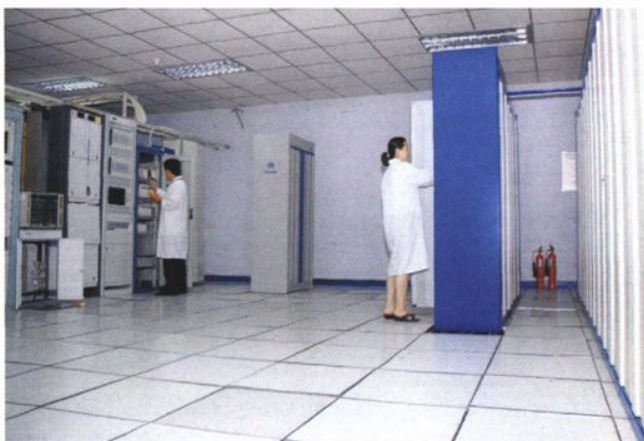
网通程控机房
