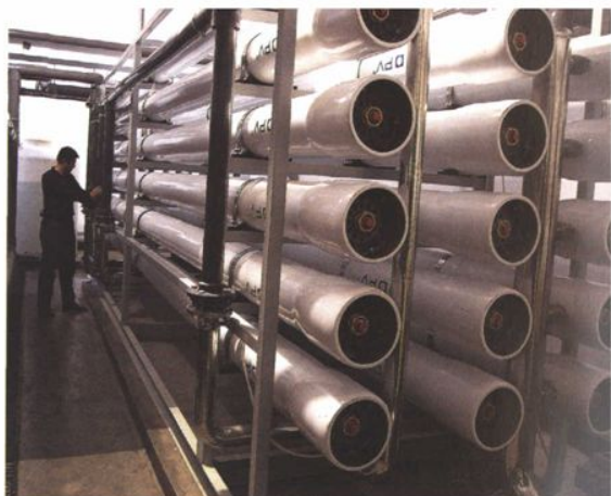
自来水除氟净化设施
