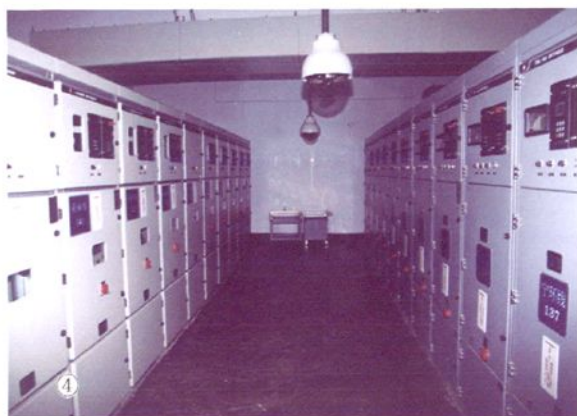
4. 2001 年，溧水县 110 千伏及以下变电站实现无人值班。图中上方为溧水县供电局变电站开关室无人视频监控设备
