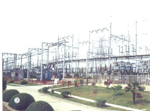
3. 1995 年 11 月 8 日，220 千伏溧水变电站首次增容的 12 万千伏·安主变压器正式投运
