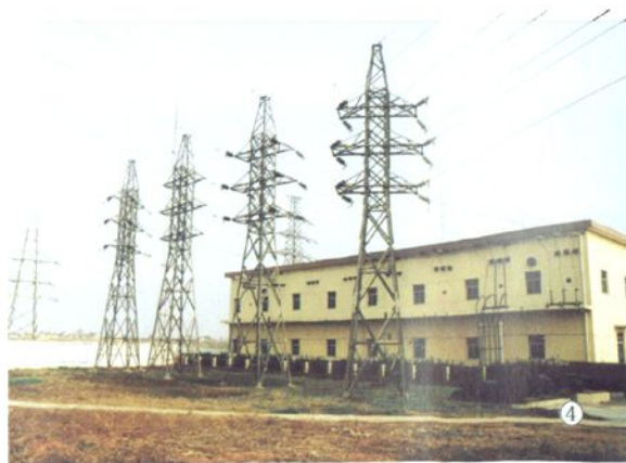
4. 1999 年 4 月，经农村电网改造工程后的 110 千伏十里牌变电站出线部分
