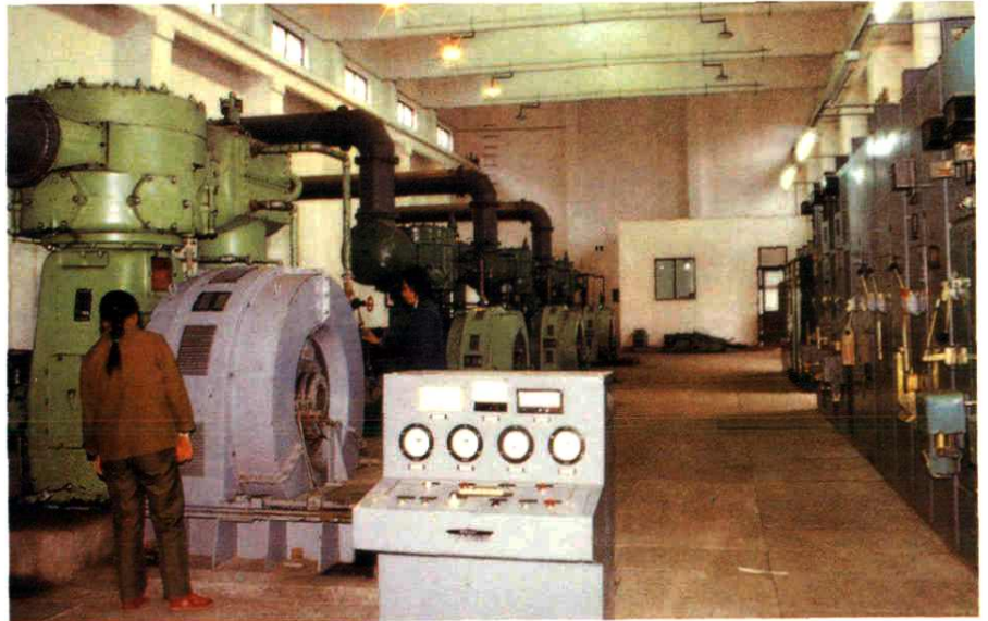
矿井压风机房
