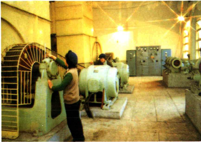
矿井抽风机房
