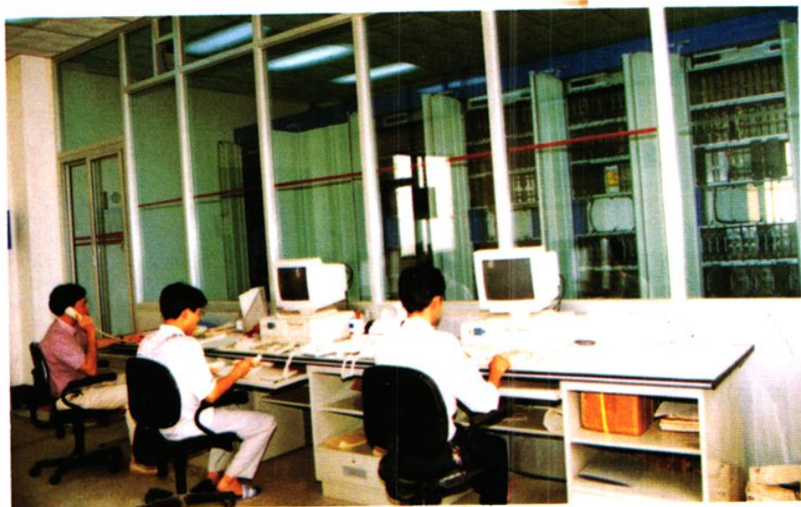
▶ S1240 程控机房一角。
