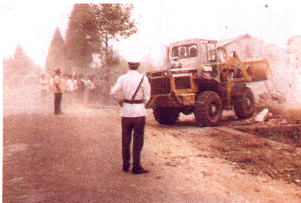
路政管理人员在衢龙公路(46省道)强行拆除违章建筑。
