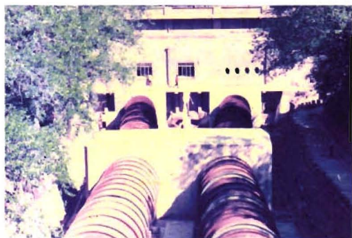
▲ 原日伪时期安装的压力钢管
