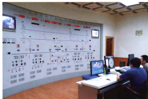
▲ 改造后的镜新厂中控室
