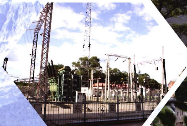
▲ 镜老厂厂东变电所
