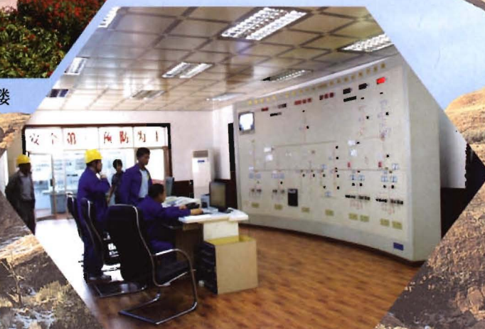
▲ 改造后的镜老厂中控室
