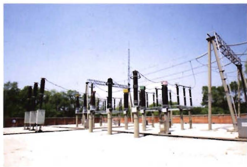
▲ 改造后的镜老厂厂西变电所
