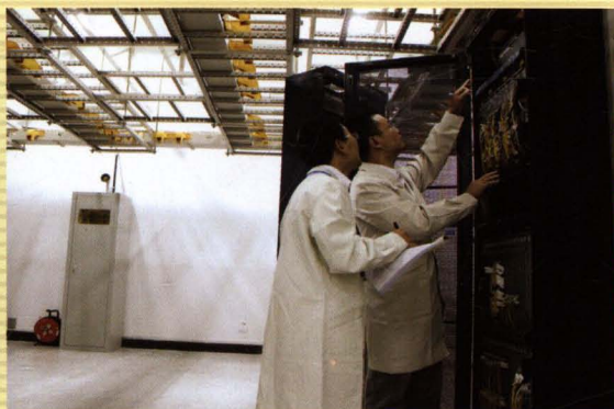
移动公司通信机房
