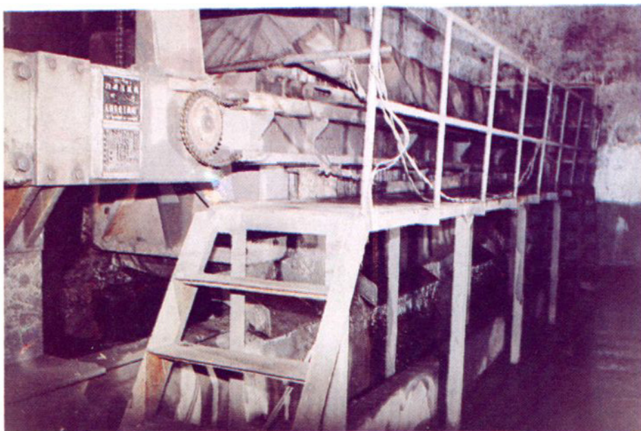
⑰洗煤车间压滤机
