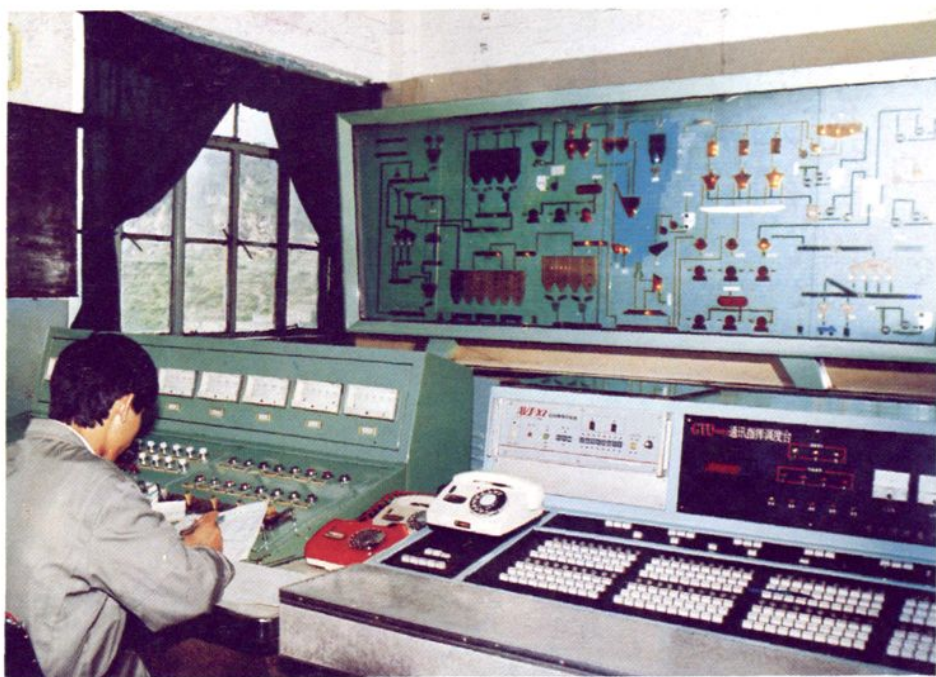
⑧ 洗煤车间集中控制室
