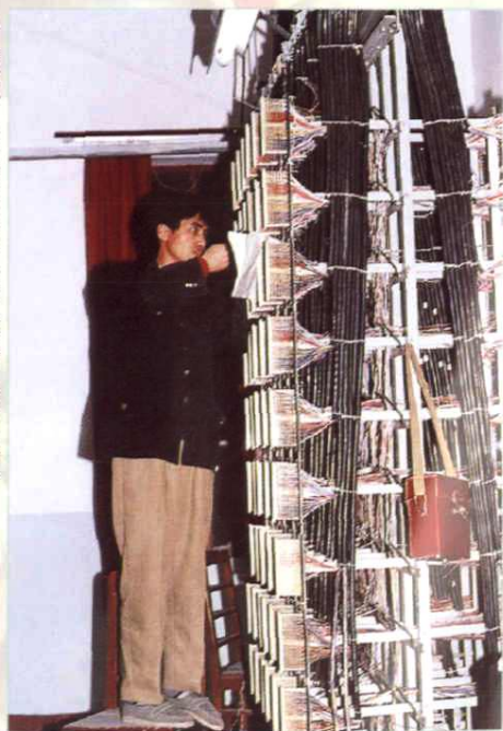
►技术人员在传输机房进行机务检测
