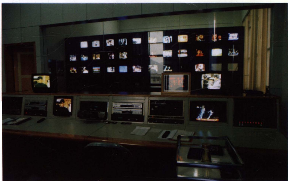
铜仁地区电视台播出机房
