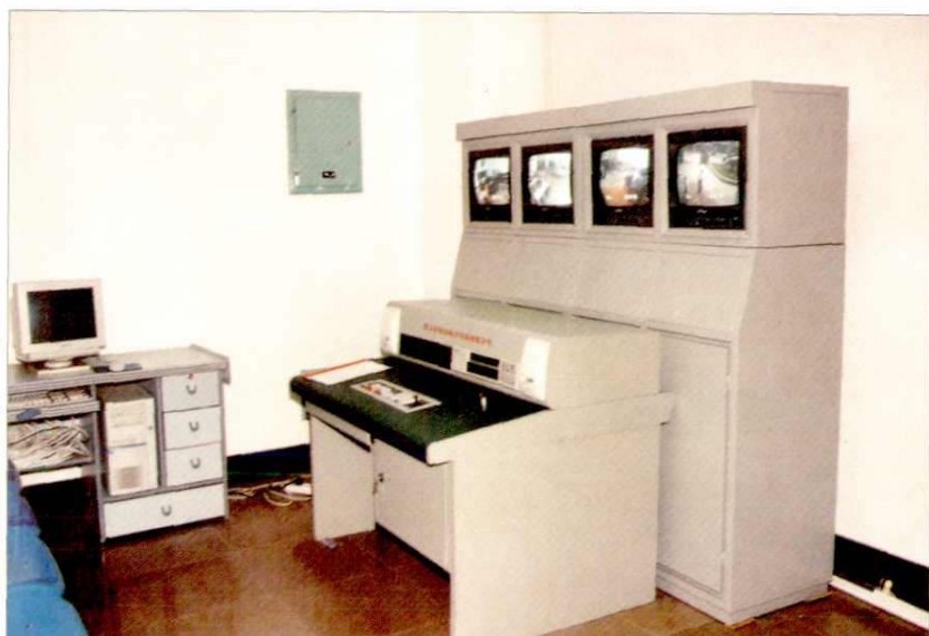
◁ 锦江区人民法院监控室。
