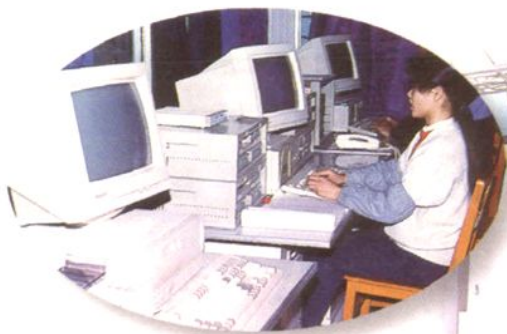
移动通信电话机房
