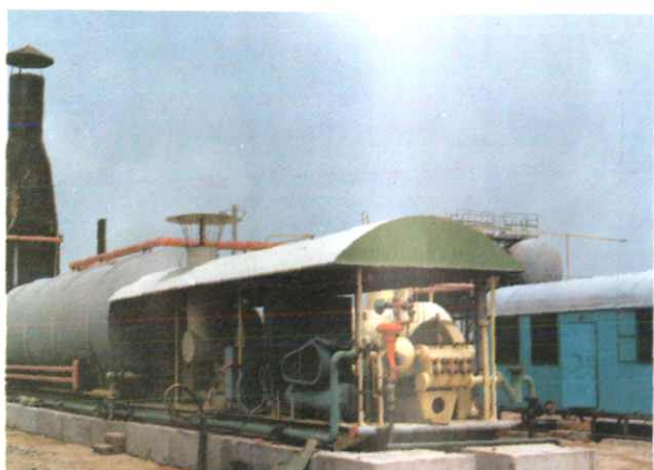
沈热注六站引进的高压蒸气炉
