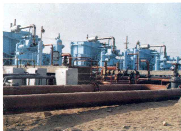
沈 2 联增压站引进的空气压缩机
