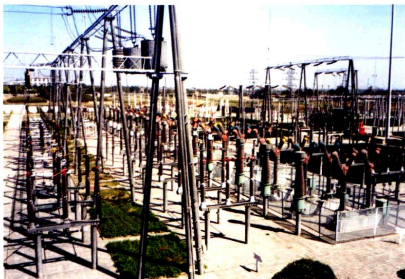
刘村 220 千伏变电站(1998 年)
