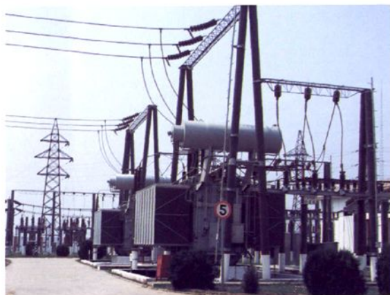
上营屯变电站
