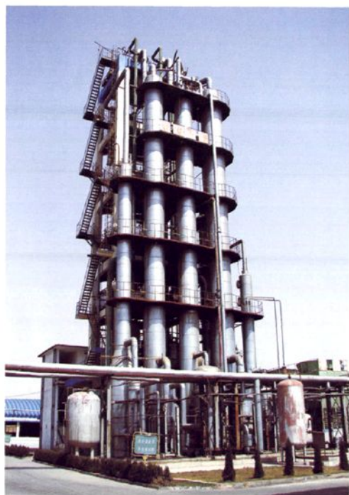
粤华化工有限公司碳酸二甲酯生产设备
