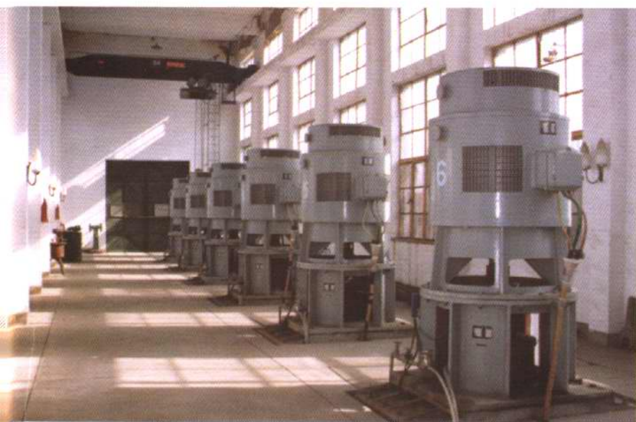
大兴水库泵站机房内景
