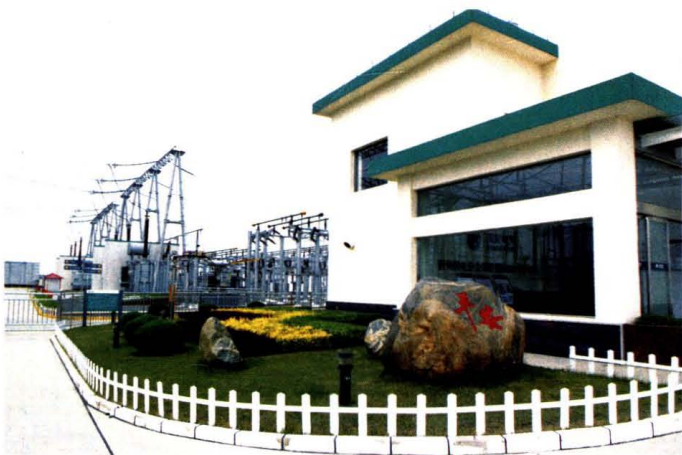
忻府区50万千伏变电站
