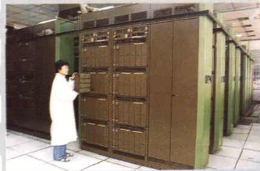
△ 程控电话交换系统
