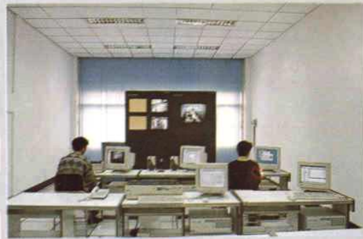
△ 动力、空调、环境监控中心
