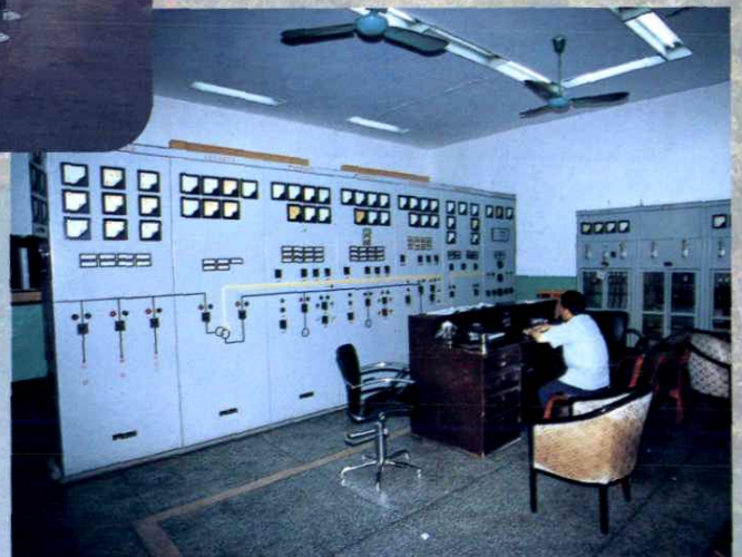
皎口电站中央控制室
