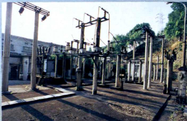
皎口电站升压站
