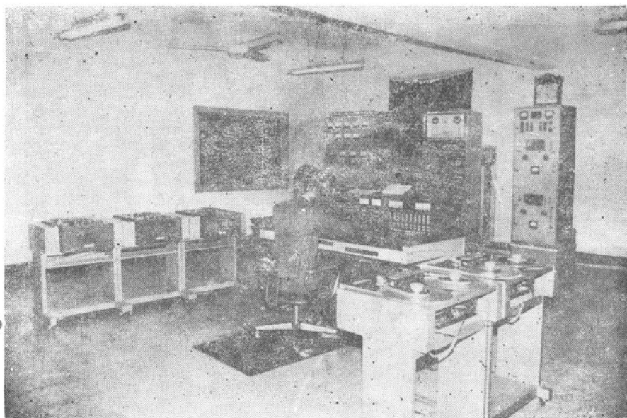
县人民广播电台机房
