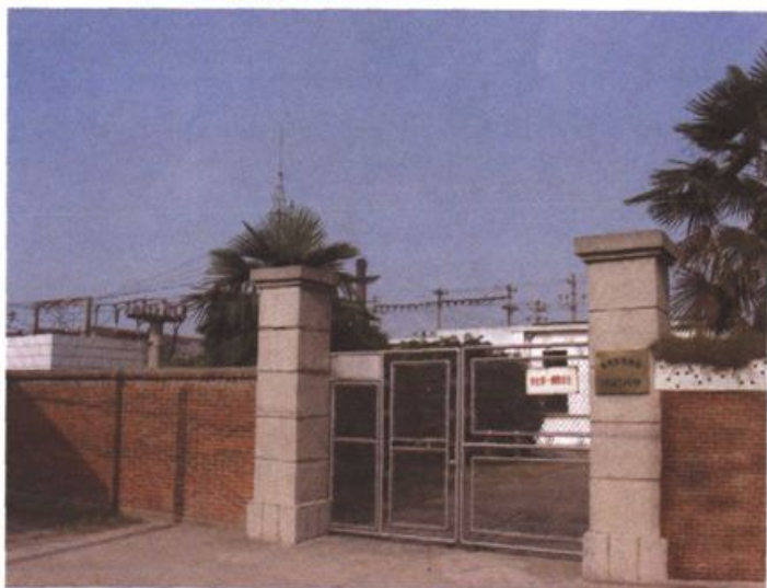
1963年建成投运的 35千伏张芝山变电所
