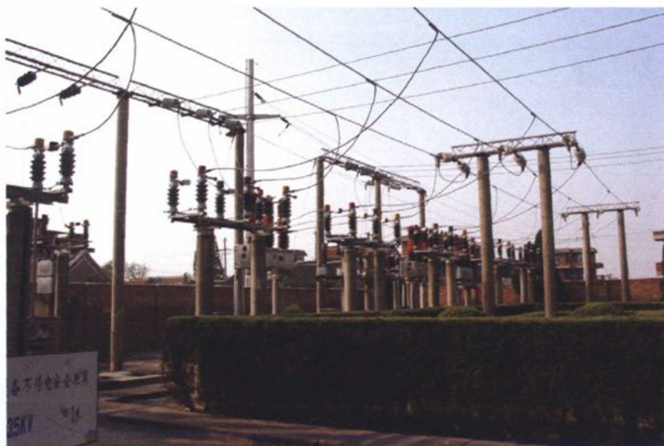
1985年投运的35千伏镇北变电所内景
