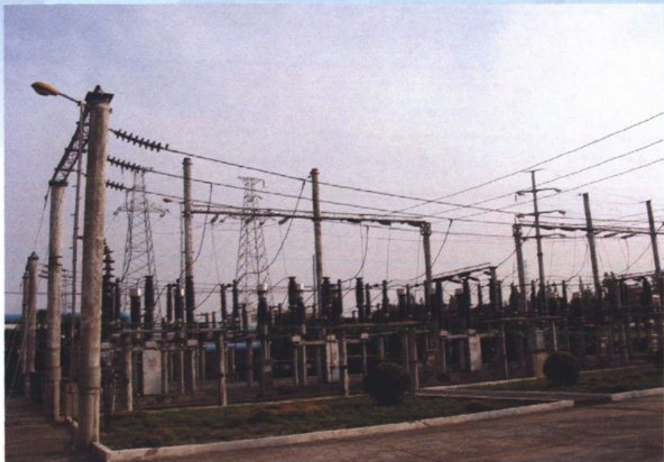
1980年，南通县建成第一座110千伏变电所——金沙变电所
