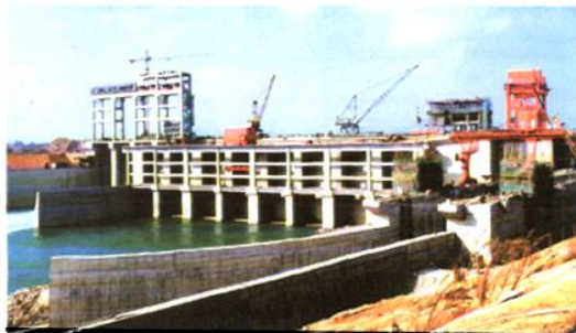
装机容量 8 \times 5.7 万千瓦，2005年2月开工兴建的红水河桥巩水电站雄姿。
