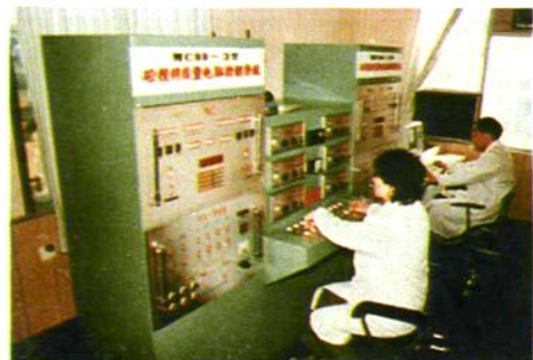
▲桥梁车间搅拌楼电脑控制室
