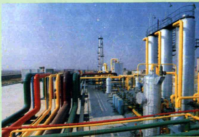
▲本厂生产的日处理 503 立方米油气分离设备
