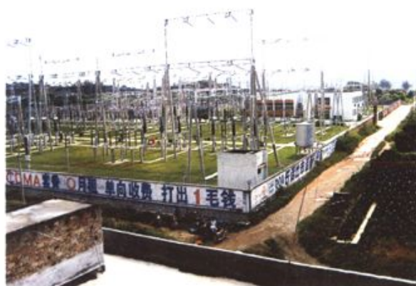
长坡 220 千伏变电站
