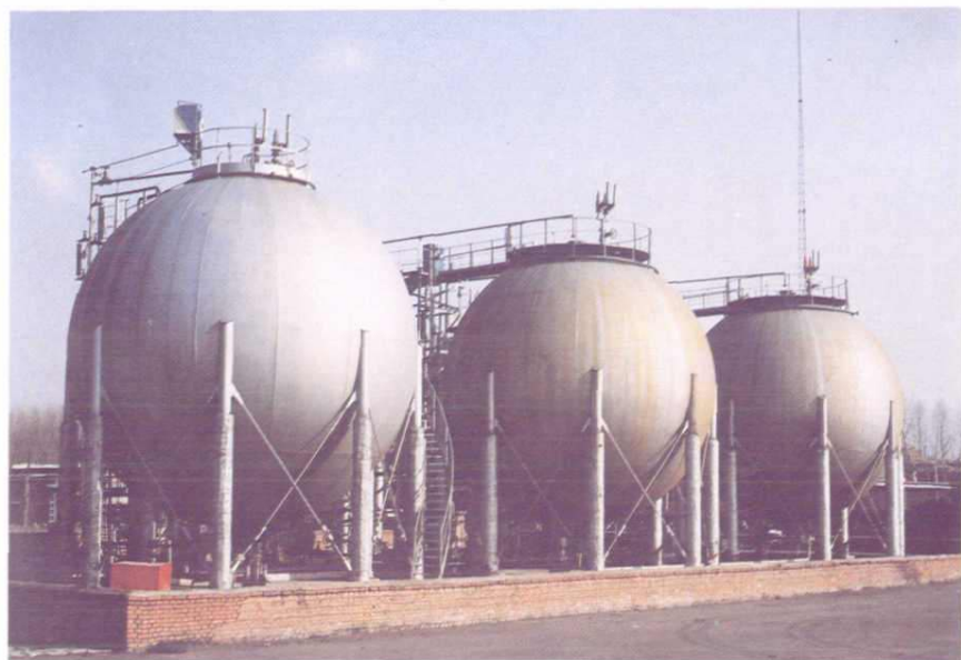
长春市煤气公司液化 气厂球型贮气罐
