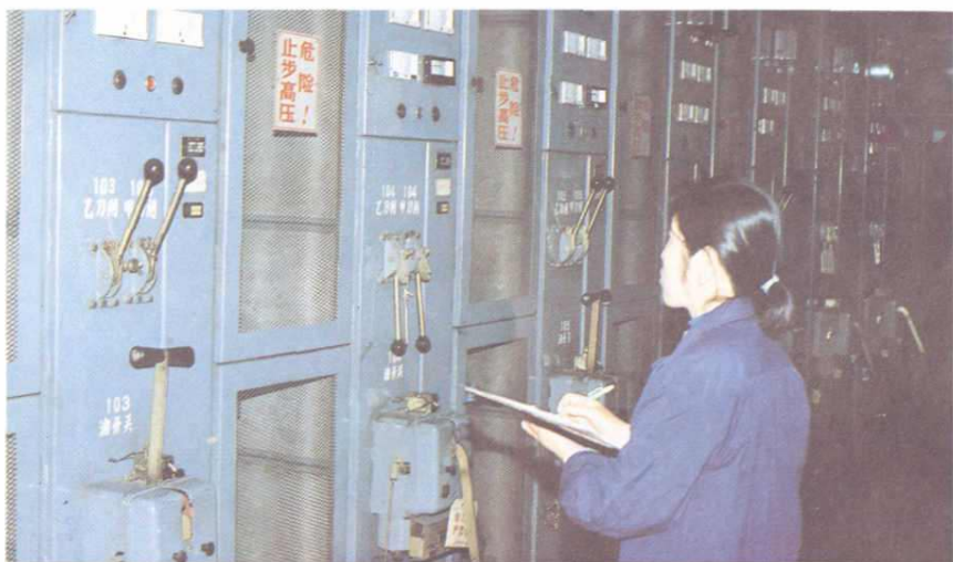
长春市煤气公司站前 煤气厂东院红旗变电所
