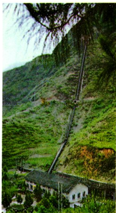
涪陵地区土坎发电厂一级站。
