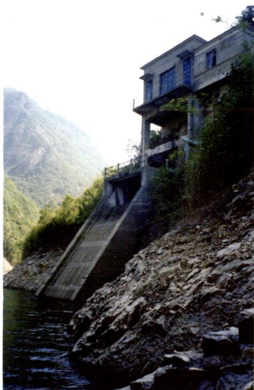
福溪水库发电隧洞进口控制闸
