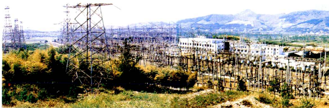
位于余杭瓶窑栲栳山的全省第一座 500 千伏瓶窑变电所
