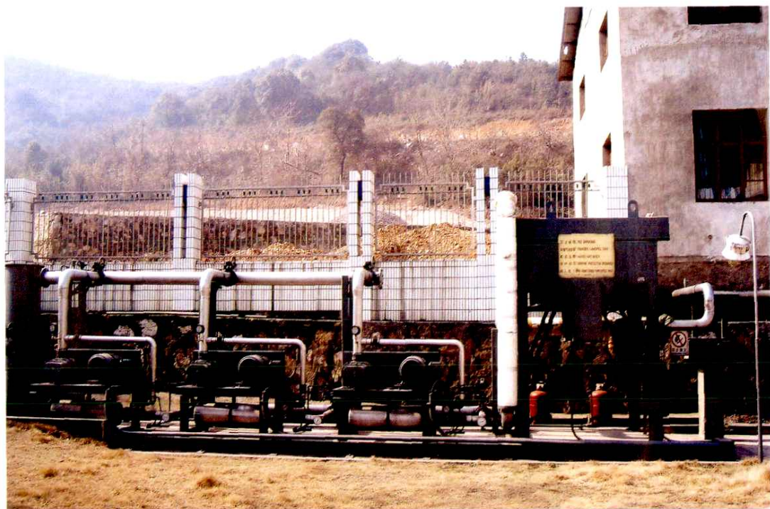
杭州中佳环境技术有限公司一角（天子岭垃圾发电）
