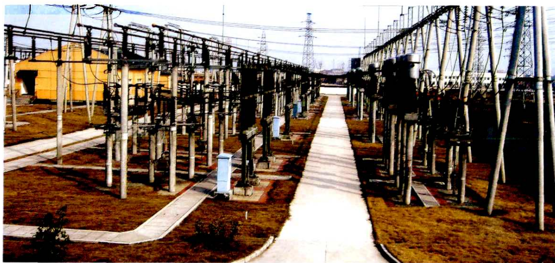
2003 年 8 月，余杭供电局首座 220 千伏乾元变电所投入运行
