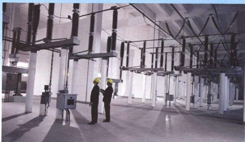
15 万千瓦机组升压站
