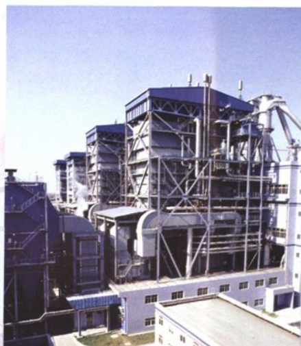
15 万千瓦机组 11 号锅炉
