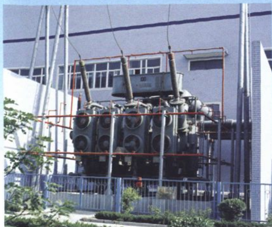
10 号机组主变压器
