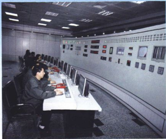
13.5 万千瓦机组集控室
